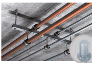
Carriles de montaje suspendidos
